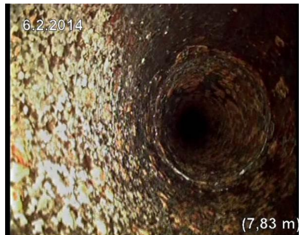
Kuva 27. V35a. Pystylinjan seinillä olevan kertymän koostumus vaihteli. Tässä viemäriin seinissä näyttäisi olevan korroosiota/sisäpuolen pinnon vaurioita, mutta kertymän takia mahdollista vauriota on vaikea arvioida.
