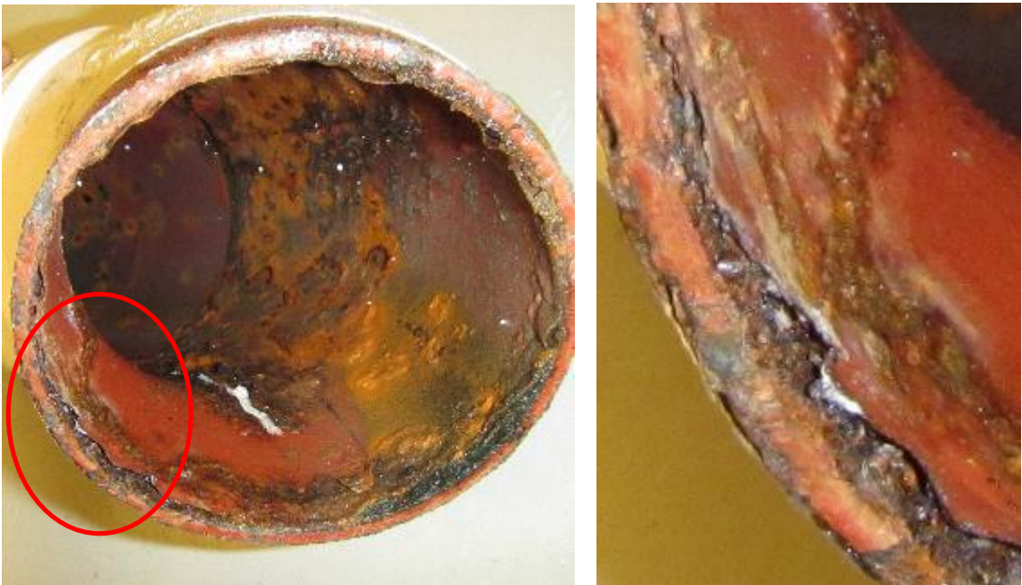
Kuva 116. Tehdasosa, jonka päädyn kulmasta on syöpyminen päässyt sisäpinnoitteen alle.
