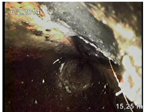
Kuva 67. V10. Vaakaosuuksilla oli hieman kertymää.
