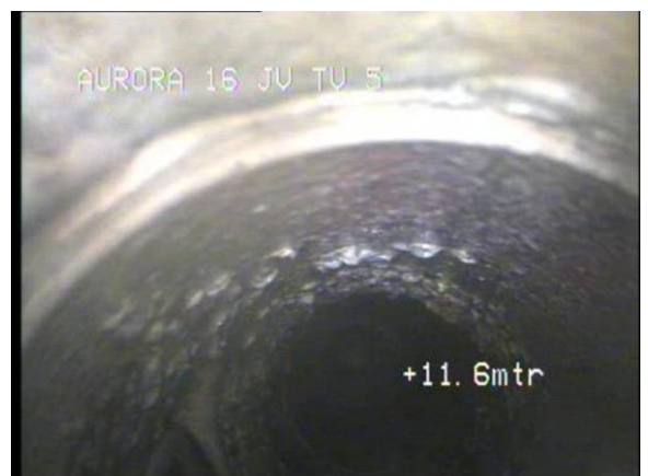
Kuva 13. Pystylinjan V5 alaosaa on hieman pa- remmassa kunnossa.
