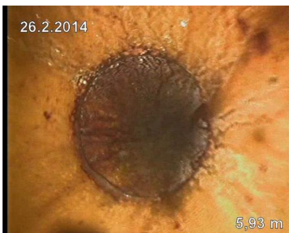
Kuva 80. T100. Jatkoskohdassa ei ole huomattavaa sisäpinnan epoksin repeilyä, mutta ruosteisia valumajälkiä alkaa jatkoksesta.
