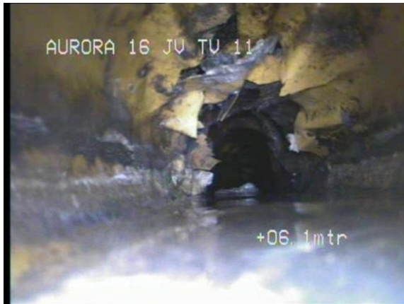
Kuva 18. Linjan V3 vaakaosuus on supistuksen kohdalta pahoin syöpynyt.
