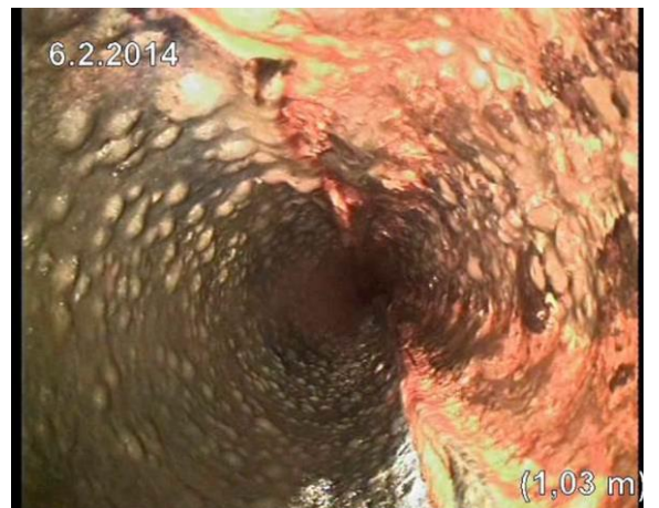
Kuva 41. V33a. Kytentäviemäriin vaakaosuudella on niin paljon kertymää, ettei putken sisäpinnan kunnosta voi sanoa mitään.
