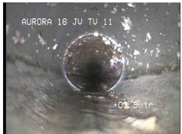
Kuva 15. Linjan V3 P-kerroksen vaakavedossa on muovilla korjattu pätkä. (Ks. kuva 1.)
