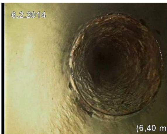
Kuva 36. V35. Pystyviemäriin jatkos kohdalla kertymän pinnanmuoto muuttuu.
