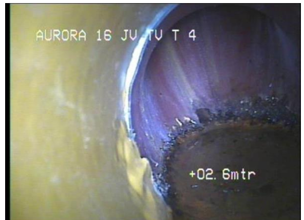
Kuva 7. Tuuletusviemäreiden notkot huonontavat toimintaa ja edistävät korroosiota. Viemäriinjojen V6,8 ja 10 tuuletus.
