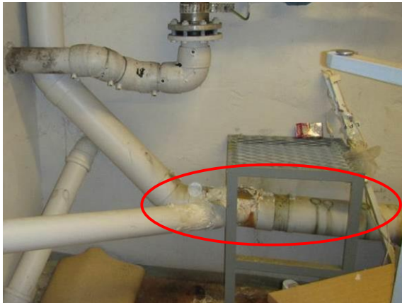
Kuva 98. Näytekappaleeksi otettiin kuvassa näkyvä viemärin haarakappale ja siitä myötävirtaan jatkuva suora putki. Kellarikerroksen vesimittarihuone.
