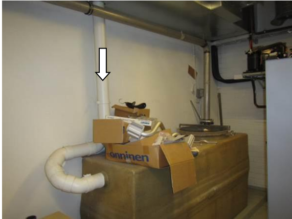
Kuva 84. V1. Linja päättyy rasvanerotuskaivoon.
