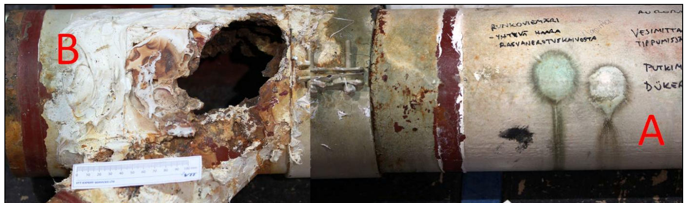
Kuva 1. Vaurioitunut viemäriputken (A) Düker yläpinta ja siihen pantaliitoksella liitetty läpisyöpynyt yhdekappale (B) Saint-Gobain.
