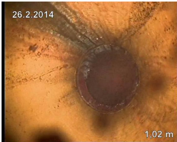
Kuva 76. T100. Tuuletusviemäri on varsin puhdas ja hyväkuntoinen
