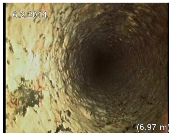
Kuva 37. V35. Pystyviemärissä on epätasaista kertymää.
