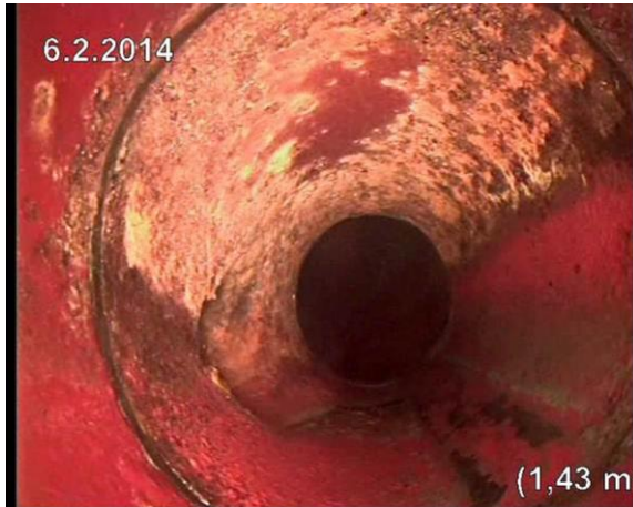
Kuva 32. V35. Haarayhde vaakakokooja-viemä- rissä. Vasemmassa reunassa ja laella näkyy alkavaa korroosiota.
