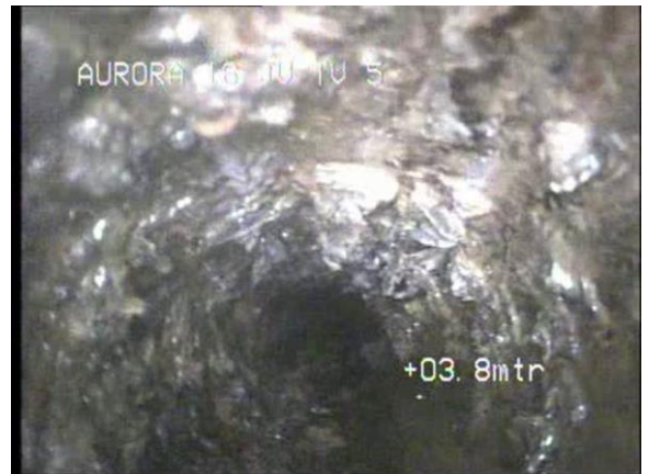
Kuva 11. Pystylinja V5:n ensimmäisen haaran jälkeen epoksi on irronnut kauttaaltaan.
