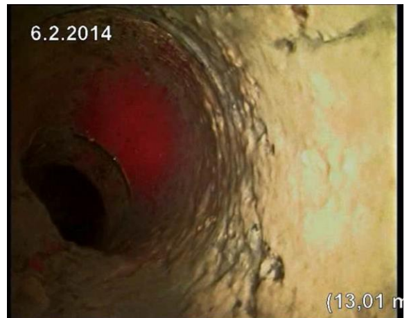
Kuva 63. V38. Kertymien määrä lisääntyy pystylinjassa alaspäin mentäessä. Samalla viemäri kunto paranee.
