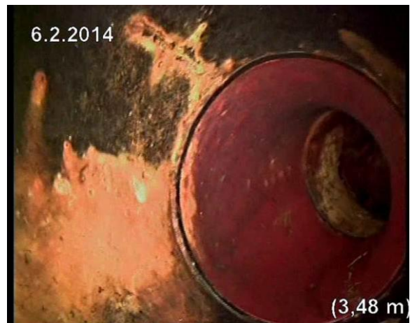
Kuva 25. V35a. Viemäriin yläosassa näyttäisi olevan pinnon halkeama. Kulmayhde on kunnossa.
