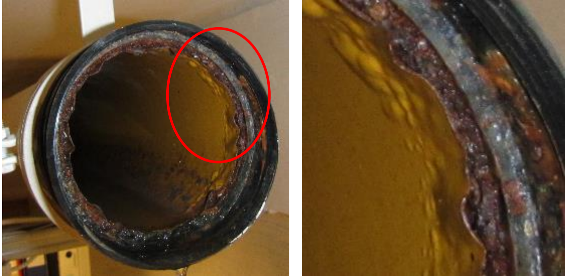
Kuva 117. Käsittelemätön katkaisupää, jossa syöpyminen on alkanut levitä sisäpinnoitteen alle.
