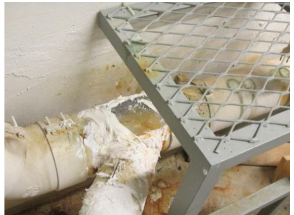
Kuva 2. Vesimittarin alla on viemäriin laki syöpynyt puhki.
