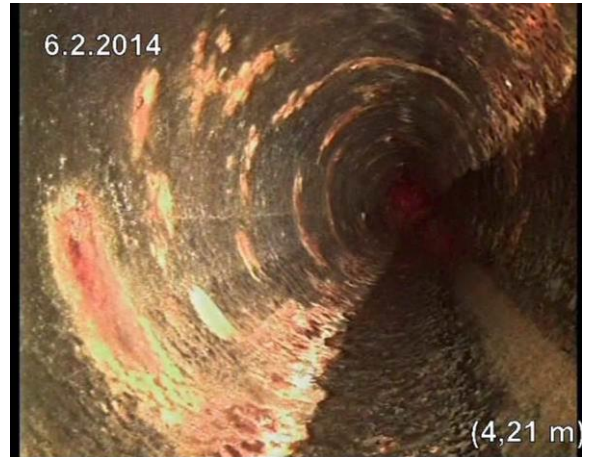
Kuva 33. V35. Vaakakokoojaviemärissä ruoste- pilkkuja sisäpinnotteessa.
