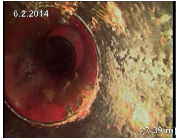
Kuva 61. V38. 6. kerroksen haaran kohdalla pystyviemäri on kunnossa.
