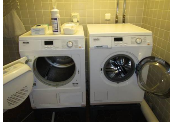
Kuva 114. Siivouskeskuksen pesukoneissa pestään ainoastaan siivousvälineitä.
