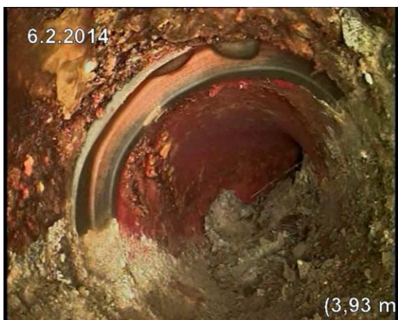
Kuva 58. V38. Vaakaviemäriosuuden lopussa on huolimattomasti asennettu panta. Kun viemärin syöpyminen etenee, viemärin laelle tulee reikä.
