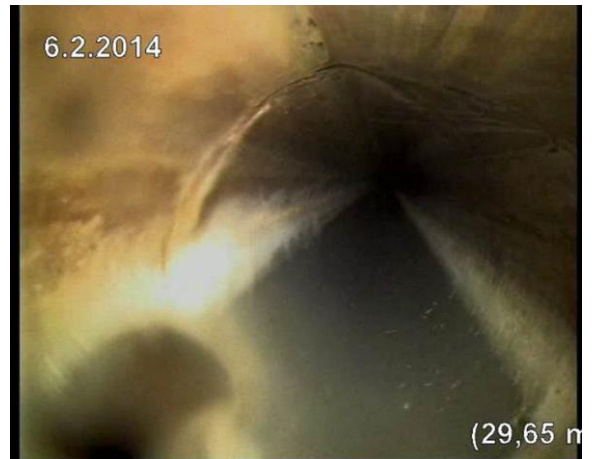
Kuva 39. V35. Linjan kääntyy alhaalla muoviseksi pohjaviemäriksi. Muovinen osuus on hyväkuntoista.
