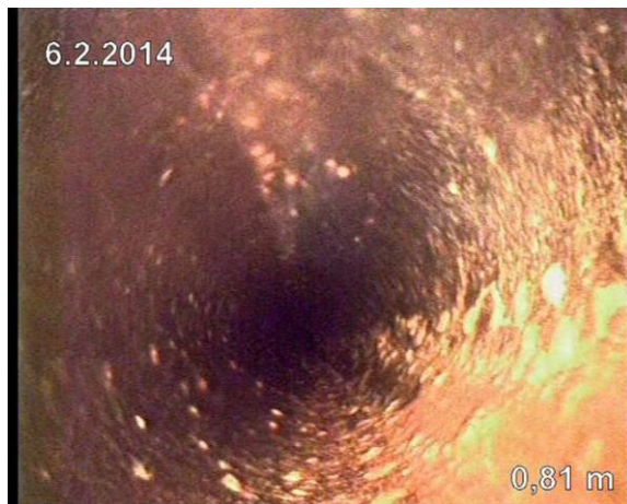
Kuva 46. V33a. Tuuletusviemäriässä ennen yhtymistä linjan V34 tuuletukseen on pitkä vaakaveto.
