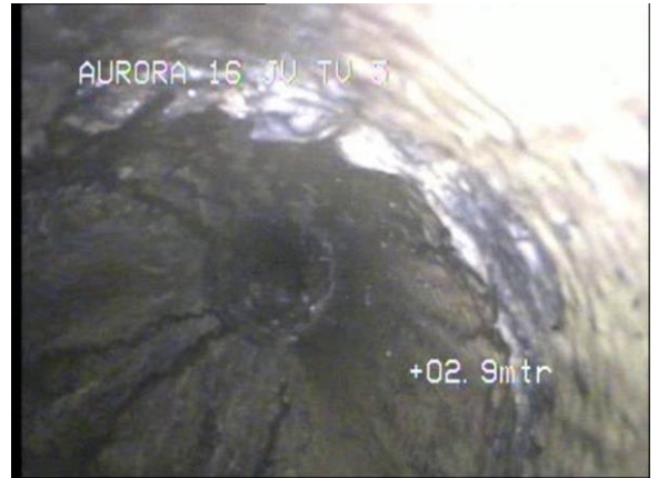
Kuva 9. Pystylinja V5:ssä on epoksin irtoamista ja syöpymää tuuletusviemärin osuudella
