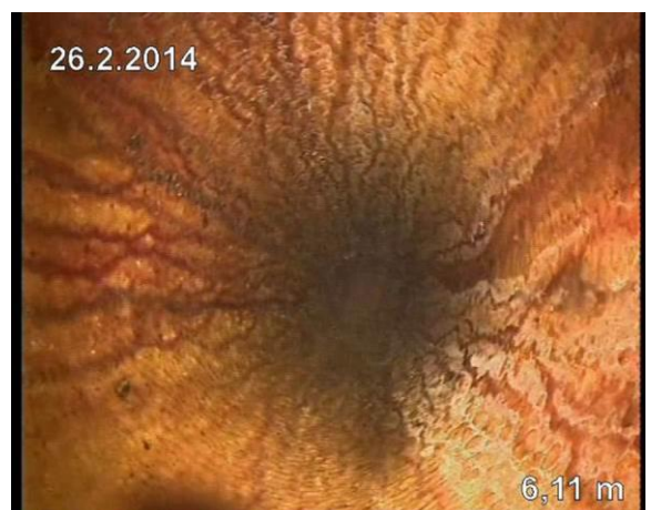
Kuva 81. T100. Jatkoskohdasta on valunut ruostetta.
