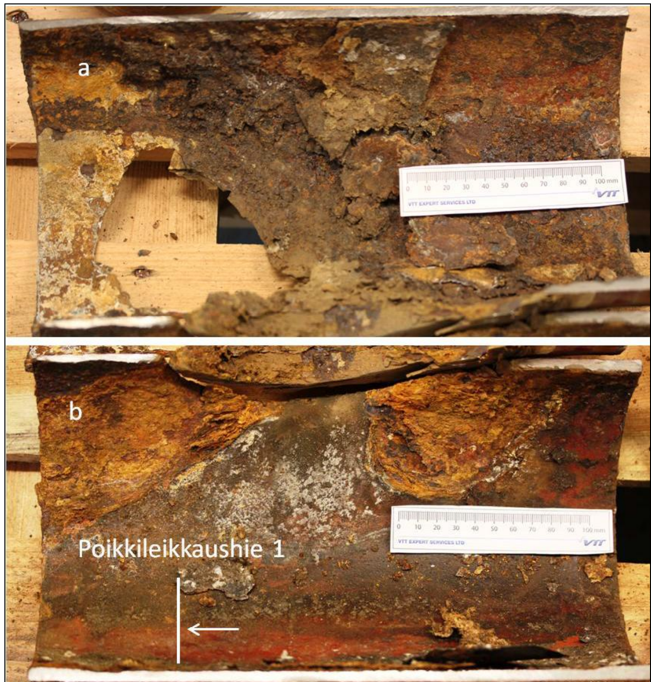
Kuva 7. Syöpyneen B (Saint-Gobain) yhteen (a) yläosan sisäpinnan ja (b) alaosan sisäpinnan valokuvat. Kuvaan 7b on merkitty valkoisella viivalla hieen leikkauslinja ja nuolella poikkileikkauksen tarkastelusuunta.
