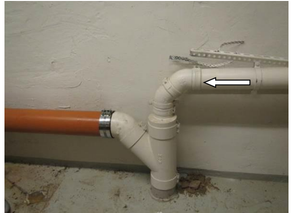
Kuva 75. Vesimittarihuoneessa T100 liittyy pohjaviemäriin laskevaan runkoviemäriin.
