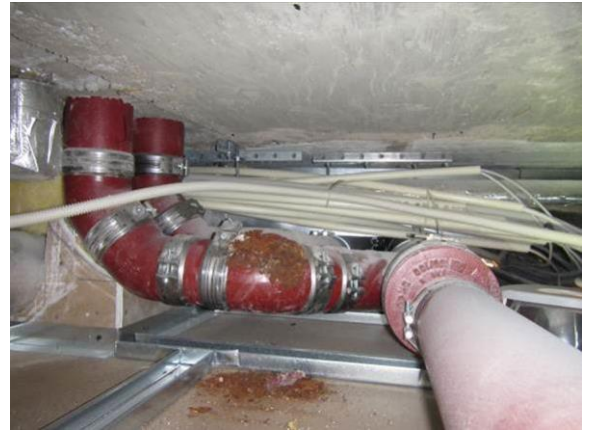
Kuva 19. P-kerros, aulan katto. Ulkopuolelta sama kohta kuin kuvassa 18. Yhtyvä pystylinja V5 on syöpynyt kulmasta puhki. Suoran putken huomattava syöpymä juuri ennen supistuskappaletta ei näy ulospäin.
