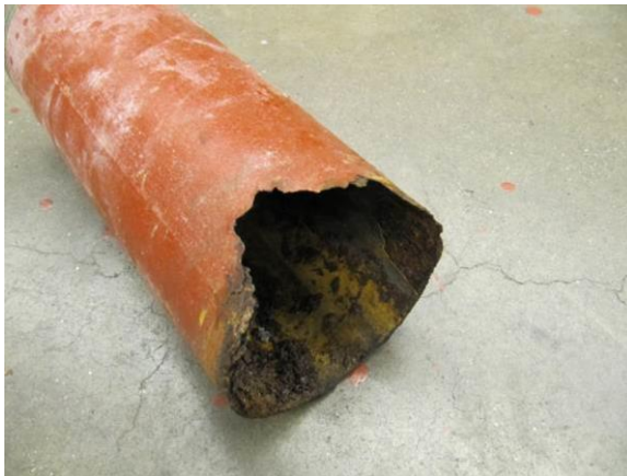
Kuva 1. Puhkisyöpynyt, vuonna 2003 asennettu valurautaviemäri on P-kerroksen katosta.
