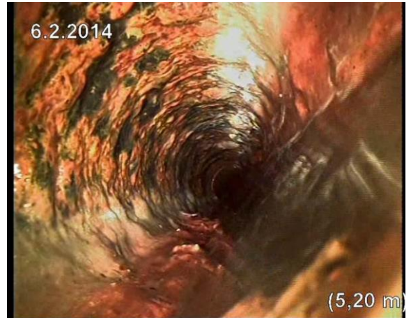
Kuva 43. V33a. Vaakaosuudella on niin paljon kertymää, ettei putken sisäpinnan kunnosta voi sanoa mitään.
