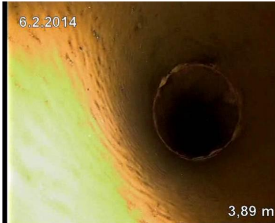
Kuva 64. V10. Eräessä katkaisu/liitoskohdassa oli alkavaa sisäpinnoitteen irtoamista.
