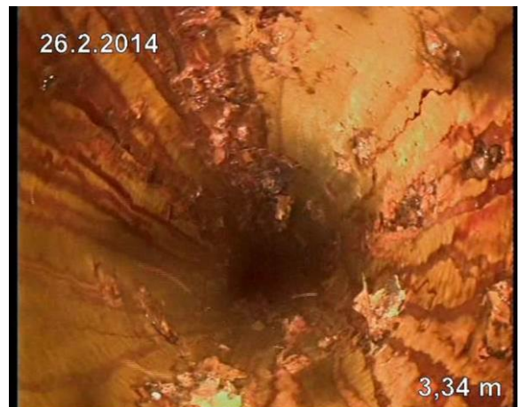
Kuva 93. V1. Pystyosuudella on suorassa putkessa huomattavaa sisäpinnoitteen hilseilyä.
