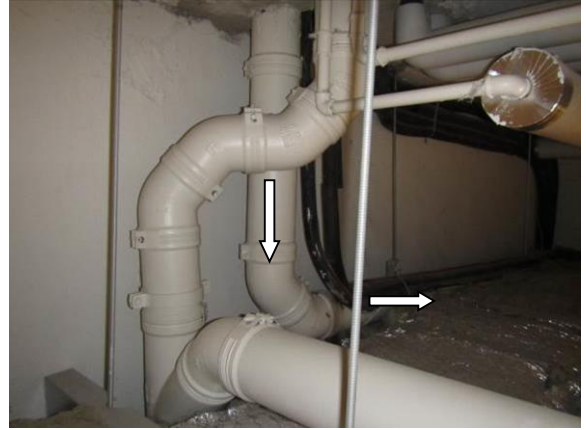
Kuva 73. T100 kellarikerroksen katossa. Tuuletusviemäri viettää nuolten suuntaan. Kuvan toinen pystylinja tulee osastojen keittiöiltä. Sivulta siihen liittyy P-kerroksen ammattikeittiön viemäroinnit.
