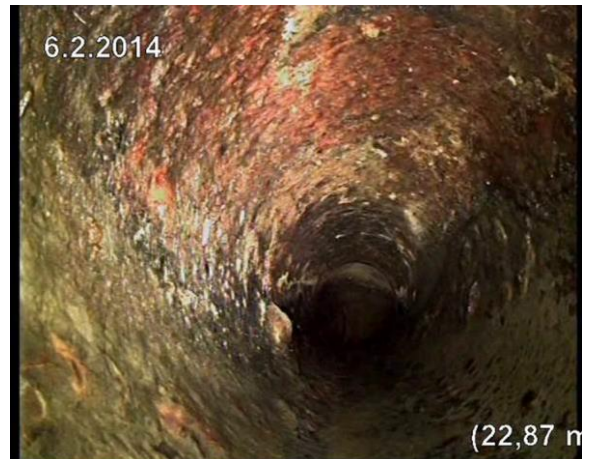
Kuva 31. V35a. Runkoviemärin vaakaosan laella näyttäisi olevan ruostunut osio. Linjan pesun jälkeen tämä saataisiin varmistettua.
