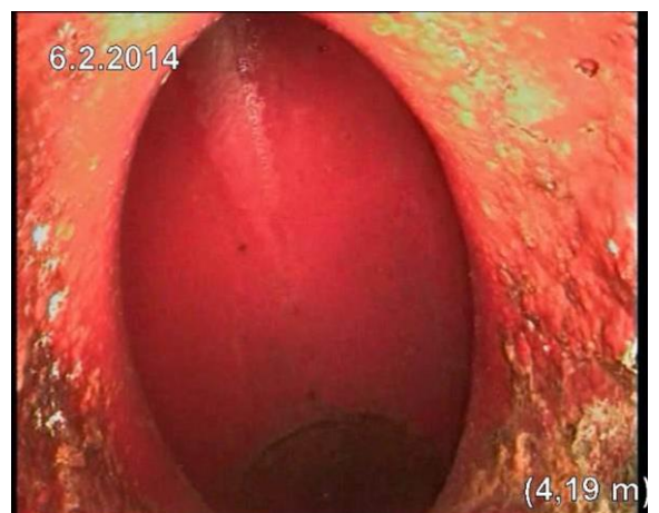
Kuva 59. V38. Liitos pystyviemäriin. Haaran sivuilla on nähtävissä maalipinnan kuplintaa ja alkavaa syöpymää.
