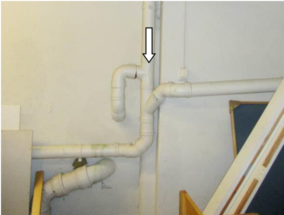
Kuva 74. T100 tulee yläkautta vesimittarihuoneeseen. Yläkautta siihen on kytketty siivouskeskuksen viemäriin tuuletus. Siivouskeskuksen jätevedet viemäroidään pumppukaivon kautta itäiseen kaupungin sekaviemäriin.
