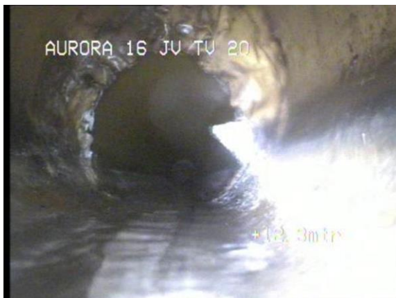
Kuva 20. Jätevesirunkolinja kellarin varastossa 002.
