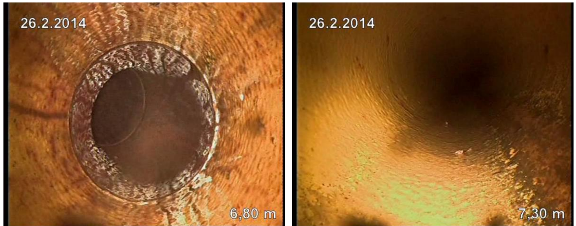
Kuva 82. T100. Jatkos ja kulmayhteet ovat kunnossa.
