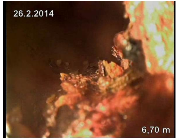
Kuva 97. V1. Pystyosuuksilta pohjakulmiin variseva sisäpinnoite ja hilseilevä valurauta pienentävät tuuletusviemäriin ilman virtausaukkoa.
