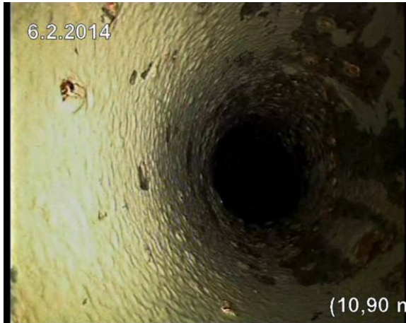
Kuva 28. V35a. Pystylinjan seinämissä on vaaleaa kertymää.
