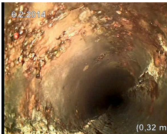
Kuva 52. V38. Lattiakaivolta lähtien valuraudan sisäpinnalla on havaittavissa ruostepilkkuja.
