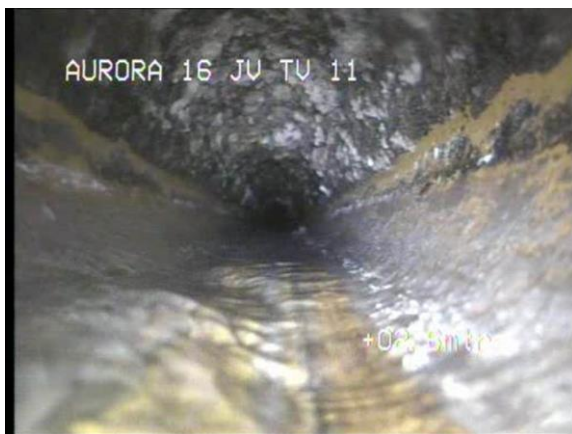
Kuva 14. Linja V3 taivuu vaakaan P-kerroksen katossa. Viemärin laella on wc-paperikertymää.
