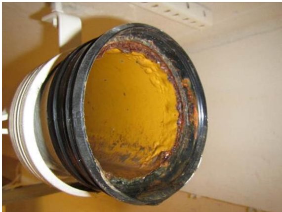
Kuva 22. Kellarin varastossa 004 irrotettiin Inva-wc:n 006 lavuaarin viemäri, jotta päästiin kuvaamaan jätevesirunkoa. Irrotetun jatko kohdalla on nähtävissä alkavat syöpyminen ja epoksin irtoilu. Valuraudan katkaisukohtaa ei ole asennusvaiheessa käsitelty epoksimaalilla.
