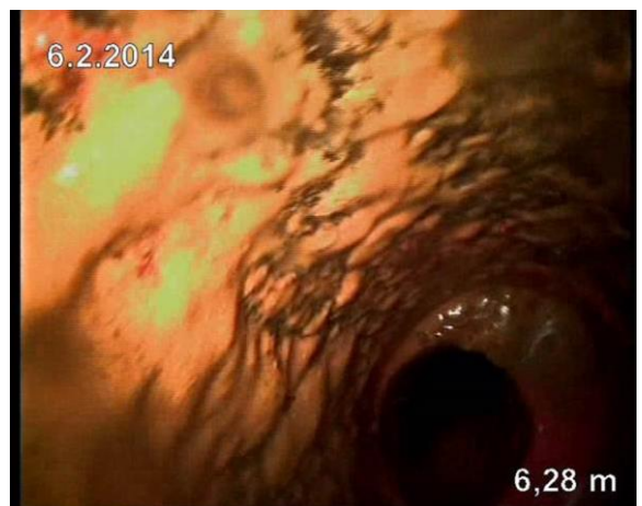
Kuva 49. V33a. Pinnon kuplintaa oli myös pystyosuudella. Edessä näkyy 7. kerroksen keittiön haara.
