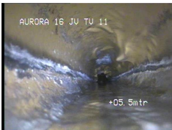
Kuva 16. Linjan V3 vaakavedosta otettiin RTG-kuva virtaussuunnassa muovilla paikatus kohdan jälkeen tästä kohtaa.
