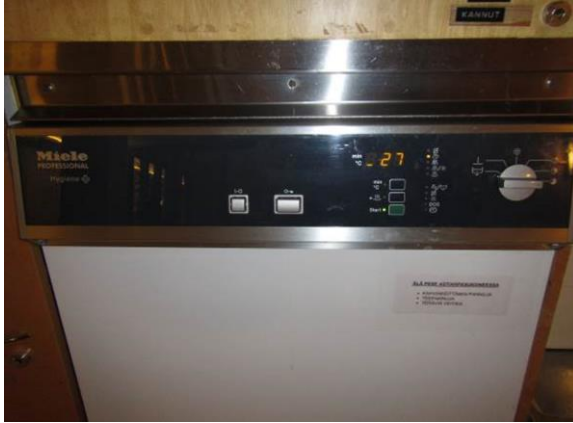
Kuva 109. Osastojen keittiöiden astianpesukone, Miele Professional Hygiene.
