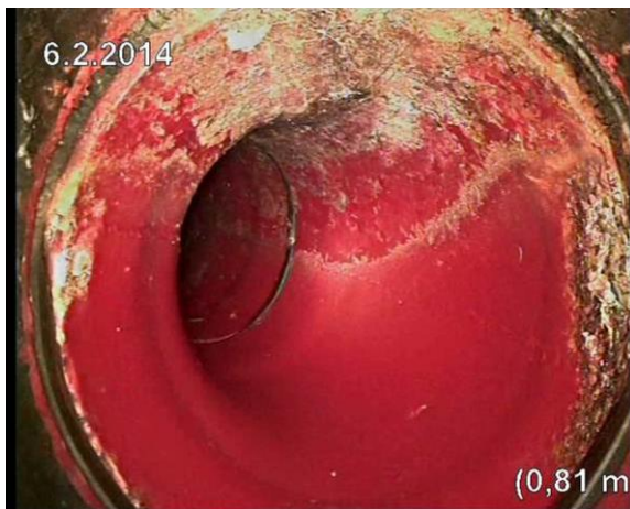
Kuva 24. V35a. Linjan yhteet ja jatkot olivat pääsääntöisesti kunnossa. Tässä on nähtävissä alkavaa ruostumista oikeassa reunassa.
