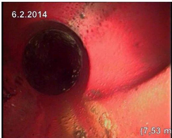
Kuva 62. V38. 6. kerroksen haara on tyydyttävässä kunnossa.
