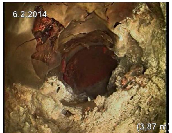
Kuva 57. V38. Epoksin repeilyä viemärin laella. Revenneen pinnoitteen alla on nähtävissä ruosteista valurautaa.
