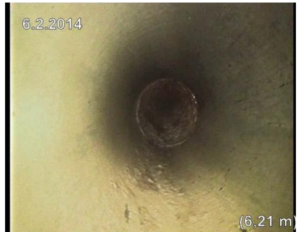
Kuva 35. V35. Pystyviemäri, jossa seinille on kertynyt ainesta hyvin tasaisesti.
