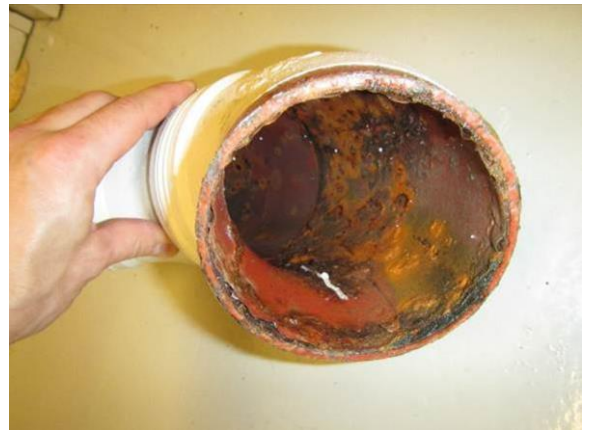
Kuva 23. Edellisen kuvan viemäriin päästävä vastinkappale. Myös tehdasosassa on selkeää alkavaa syöpyä.
