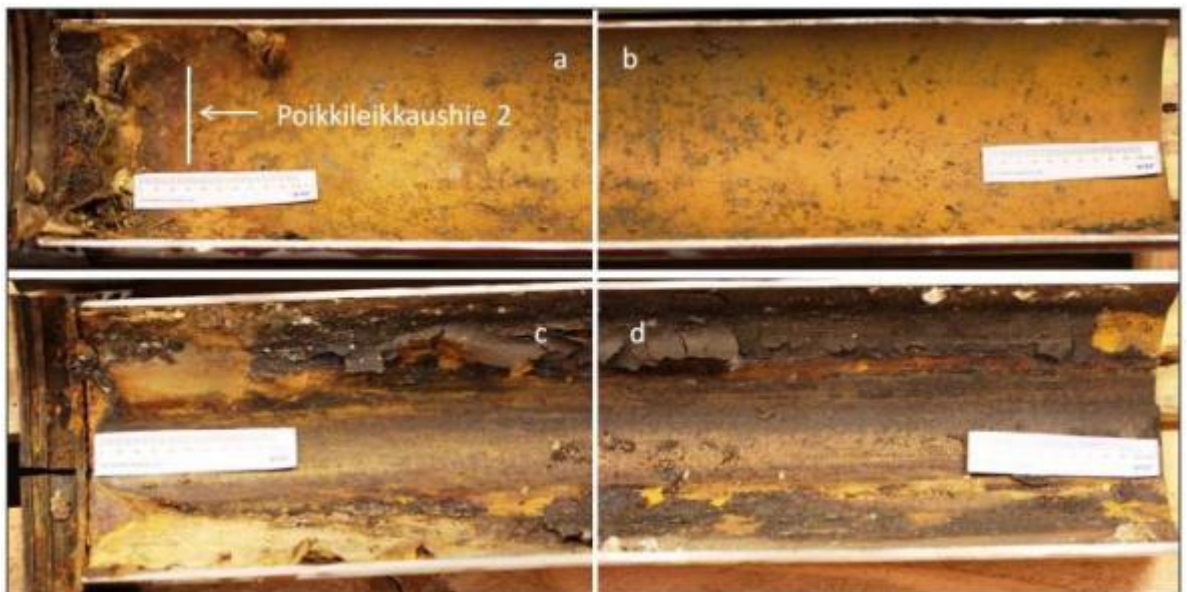
Kuva 100. Haaran jälkeisen suoran putken (tutkimuskappale A) sisäpinta. Alemmassa kuvassa on putken alapinta. Ylhäällä vasemmassa kulmassa on selvästi nähtävissä epoksin irtoamista ja ruostumista käsittelemättömässä liitoskohdassa. Käsittelemättömän jatkoksen yläpinta (a) on syöpyneyt huomattavasti enemmän kuin alapinta (c). (Liite 10, s.5)
