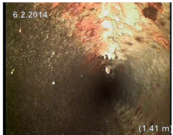
Kuva 53. V38. Vaakaosuudella putken sivulla on ruostepilkkuja.
