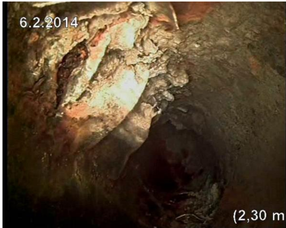
Kuva 54. V38. Ensimmäisen vaakaviemäri-osuuden loppupuolella on viemärin laella huomattavaa sisäpinnoitteen repeilyä.
