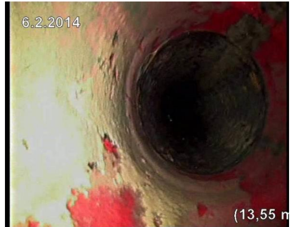
Kuva 29. V35a. Pystylinjan haarayhteet olivat kunnossa.
